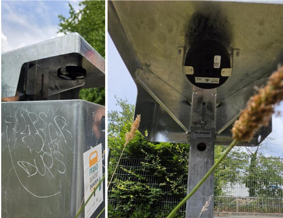
Füllstandsensor in einem 43 L Papierkorb unter dem Dach angebracht
